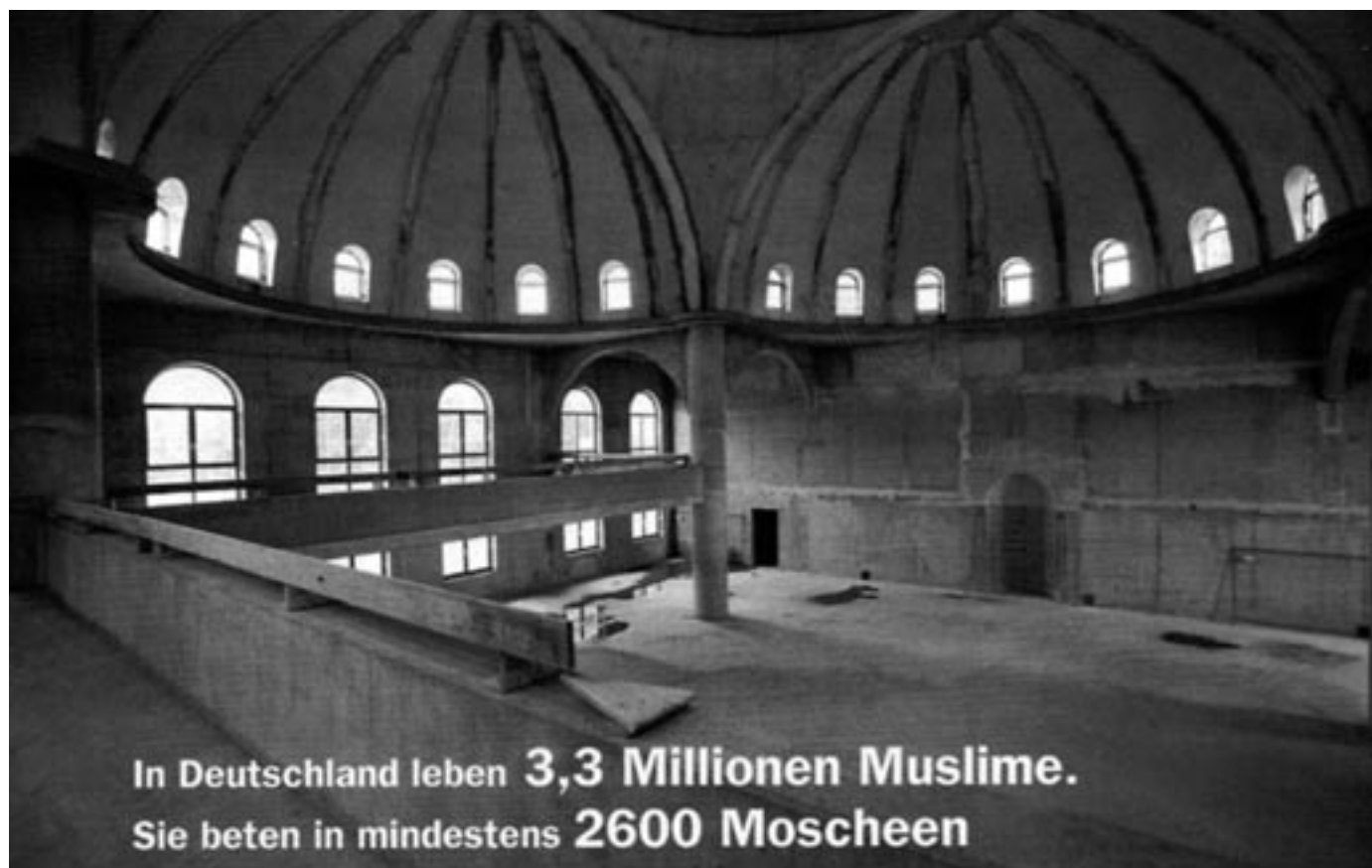
Rohbau: Im Duisburger Stadtteil Marxloh entsteht Deutschlands größte Moschee. Ende des Jahres soll der Komplex fertig sein, einschließlich Bildungs- und Begegnungsstätte.
