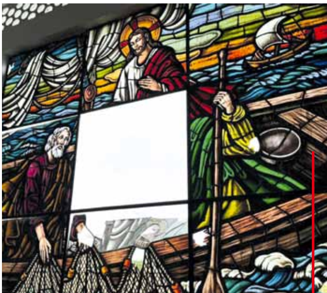
Beschädigtes Kirchenfenster im Verwaltungsgebäude des Apostolischen Vikariats Guapi im November 2024. Das Haus wurde bei einem Bombenanschlag einer Guerilla-Gruppe auf eine benachbarte Polizeistation schwer getroffen
